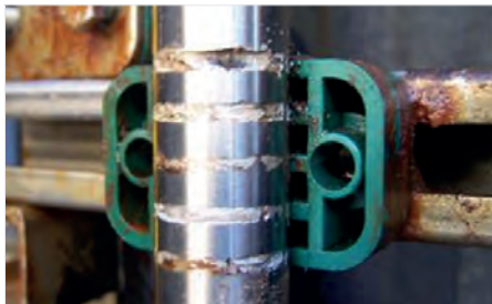
Spaltkorrosion unter einem üblichen Schellenkörper
