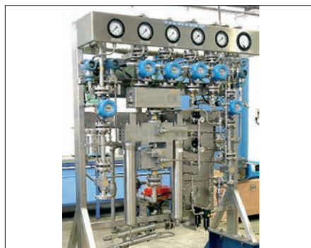
Filterstation für die Filtration von Gasen mit STAUFF 3-Wege-Umschaltkugelhähnen für 250 bar / 3600 PSI und +200 °C / +392 °F.
